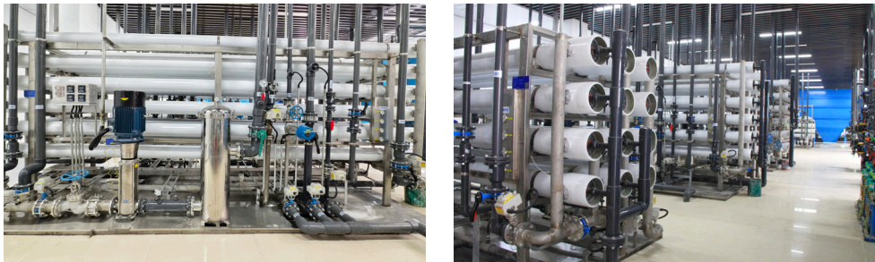
湖北吉星新建污水处理站
