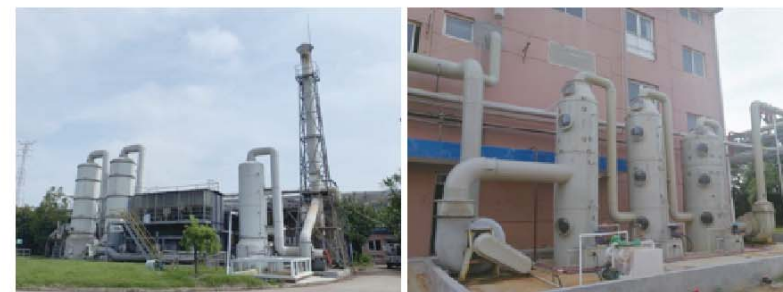
废气处理设施
