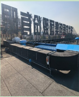
▲ 公用设备排风余热回收再利用项目
