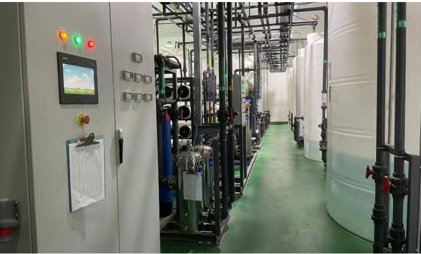
科宁达电镀工序设有含镍废水、含铜废水和含铬废水中水回用设施各一套，实现约 50% 的废水回收再利用
