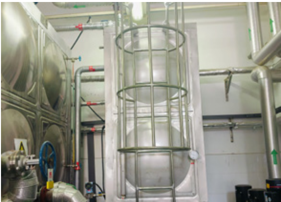
收集使用蒸汽冷凝水余热，用于加热生活热水和锅炉补水
