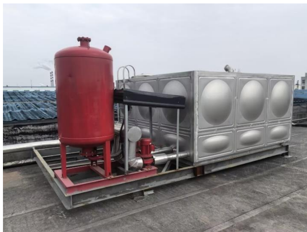
图 6：新增的高位水箱稳压系统
