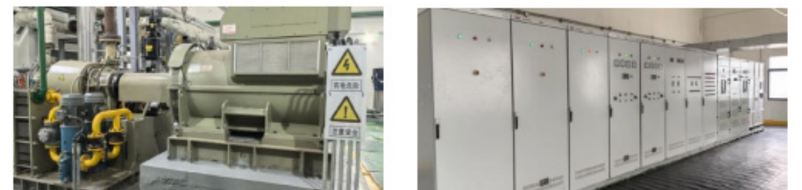
盛屯能源余热发电项目
