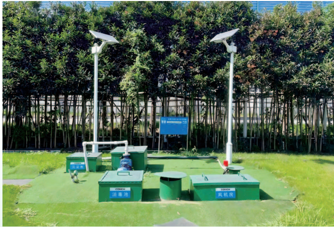
樂清海螺污水處理設施
