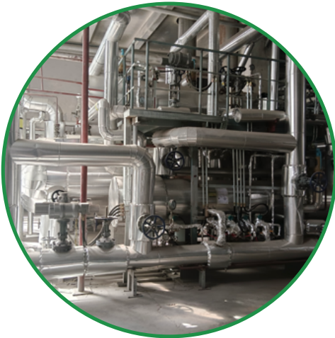
电石厂石灰窑余热回收装置
