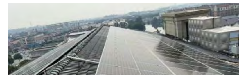
常熟农商银行网点屋顶光伏实景图
