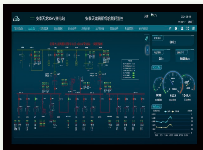
安泰天龙能耗监控平台
