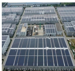
安泰天龙屋顶光伏
