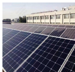
安泰爱科屋顶光伏
