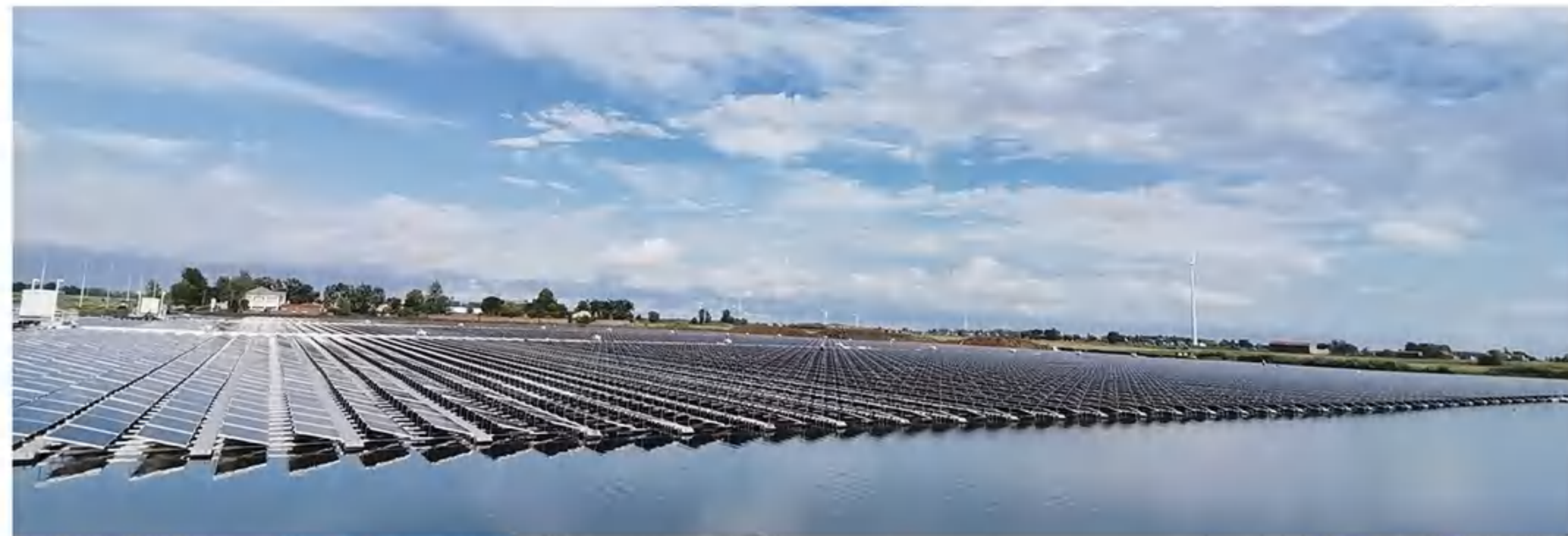
利用采煤沉陷形成的湖面建起光伏发电项目
