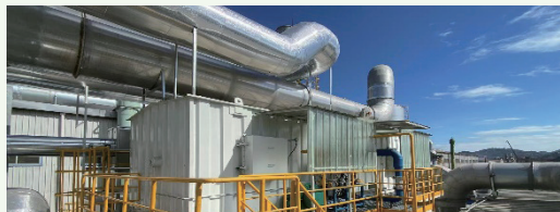
▲ 漳州中集VOCs治理项目
