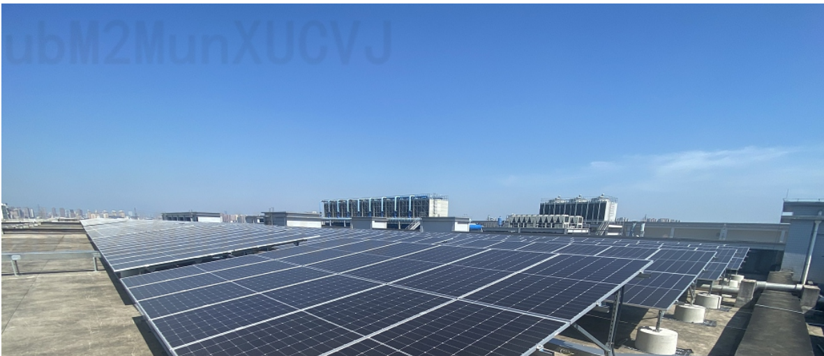
2024年7月，蓝思科技屋顶分布式光伏项目（一期16.17MW）黄花园区顺利全容量并网发电。2024年11月，蓝思科技在黄花园区隆重举行了光伏发电项目全容量19.1MW并网投产仪式。
