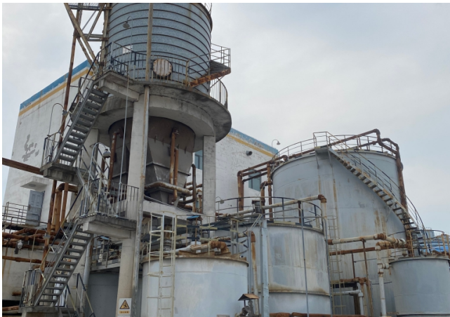
液压油、盐酸储罐隐患排查
