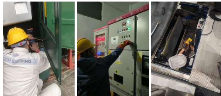
工作人员检修客运枢纽设备设施，了解其运行及能耗情况
