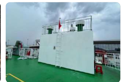
甲板上布置的电气房及电缆卷盘
