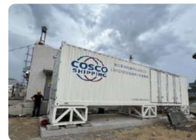
码头岸电设施岸电箱
