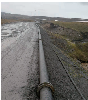
矿井涌水输送管道
