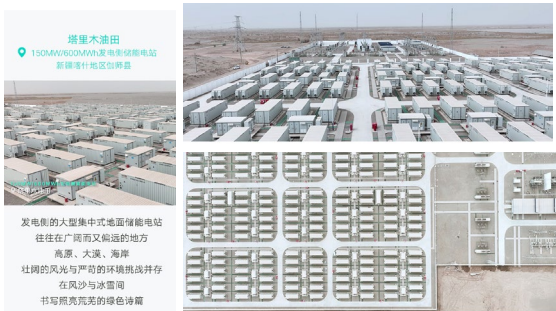
塔里木油田发电侧储能电站项目
