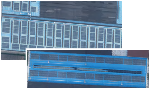
屋顶分布式光伏发电
