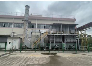
RTO 焚烧设施
