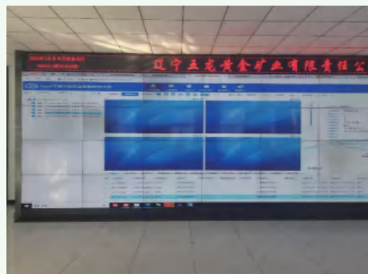
五龙矿业尾矿库在线监测系统
