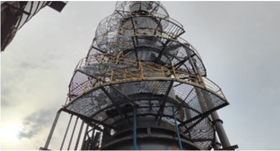
海正杭州工厂废气处理系统
