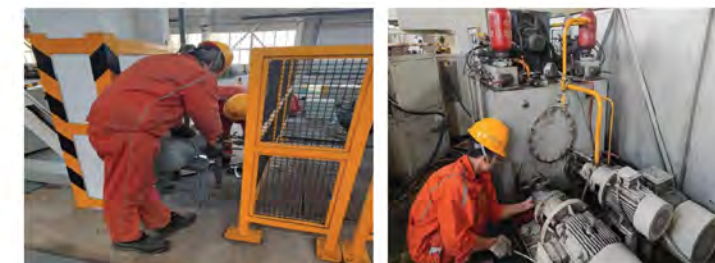
能源设备维护人员对能源管理设备开展专项检查
