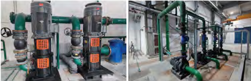
公司所属中铁山桥辙叉分公司铸造工序技术改造项目引入新型冶炼设备冷却水循环系统 该系统补水量较技改前降低了1/3
