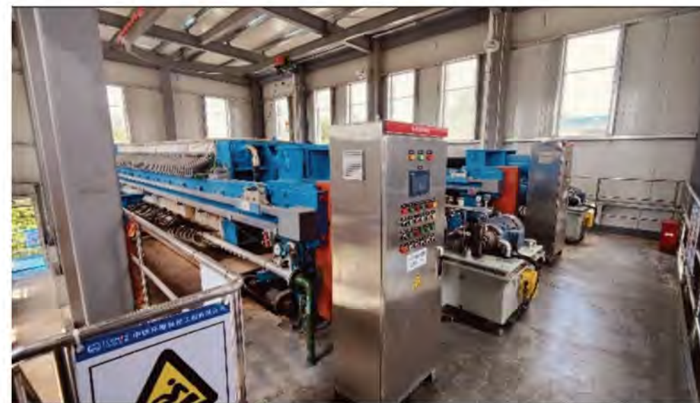
公司所属中铁环境研制的隧道施工污水处理及回用装备，已在多项重大水利、铁路工程中得到应用，显著降低了能耗、药剂消耗及占地面积，节约了成本，提升了水质
