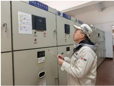
员工监测供电系统运行数据
