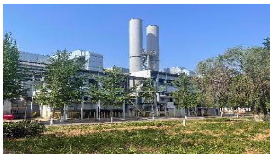
废气治理设备
