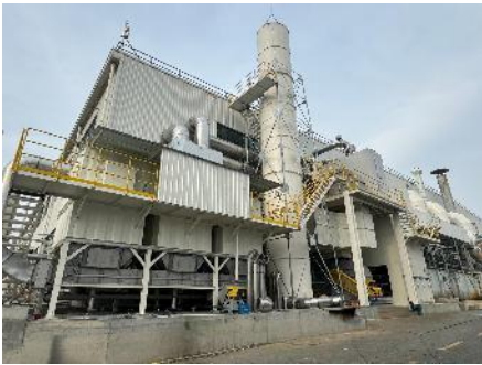
废气治理设备
