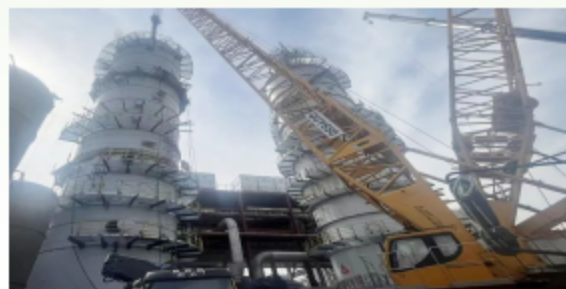
公司承制的新疆八一钢铁股份有限公司2500m 3 富氢碳循环氧气高炉(HyCROF)商业化示范项目CO 2 脱除系统吸收塔、再生塔
