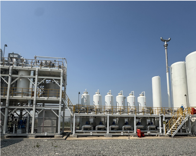
南沙基地氢气项目现场
