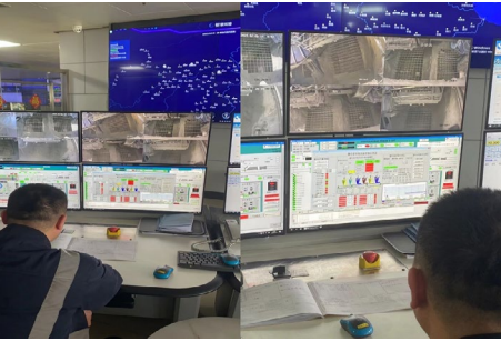
翻车机底层洒水无极调整技术，能够精准控制煤炭补水率，降低煤炭在皮带运输中的起尘率
