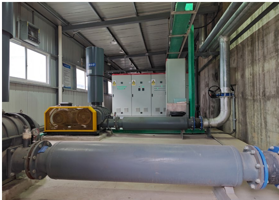
江苏可兰素污水站设施
