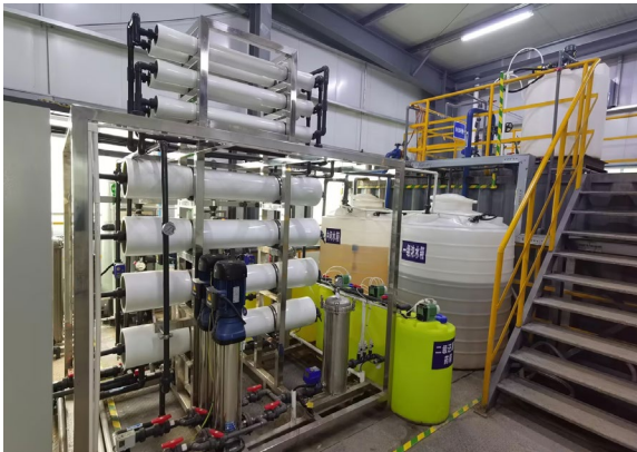
江苏纳米污水站设施
