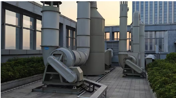
“碱液喷淋塔 + 活性炭协同吸附”工艺设施
