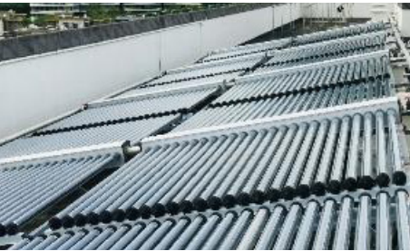
三亚瞻云精选酒店光伏铺设
