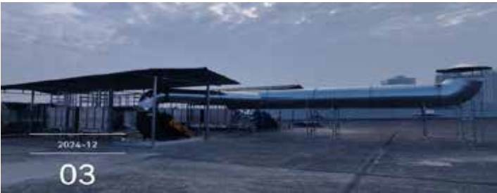
波峰焊及三防涂覆废气处理装置
