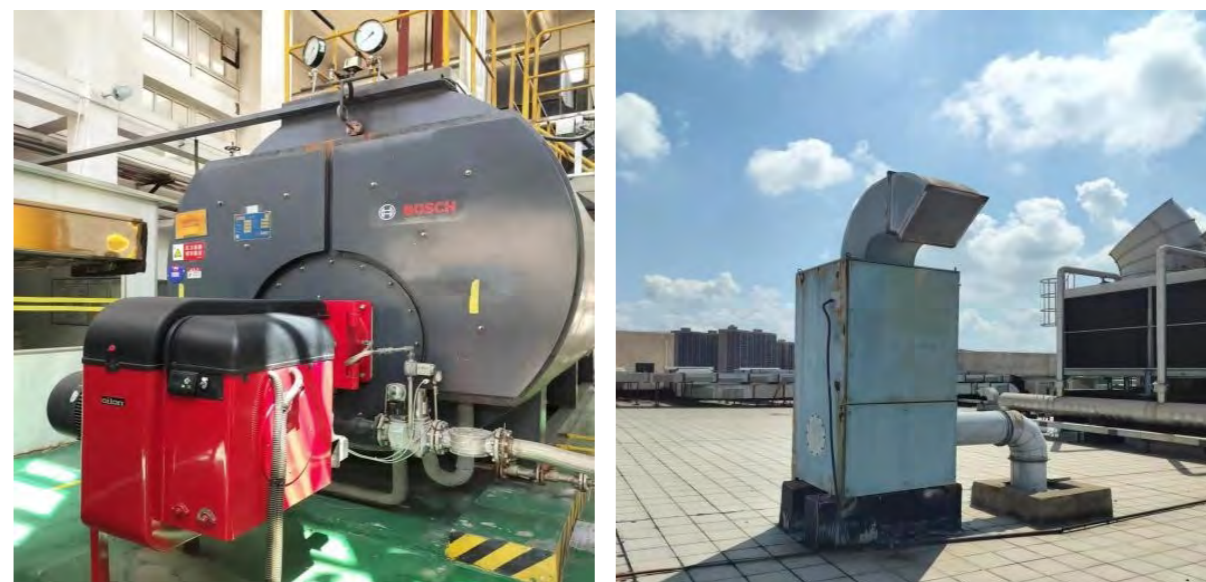
废气外排处理设施
