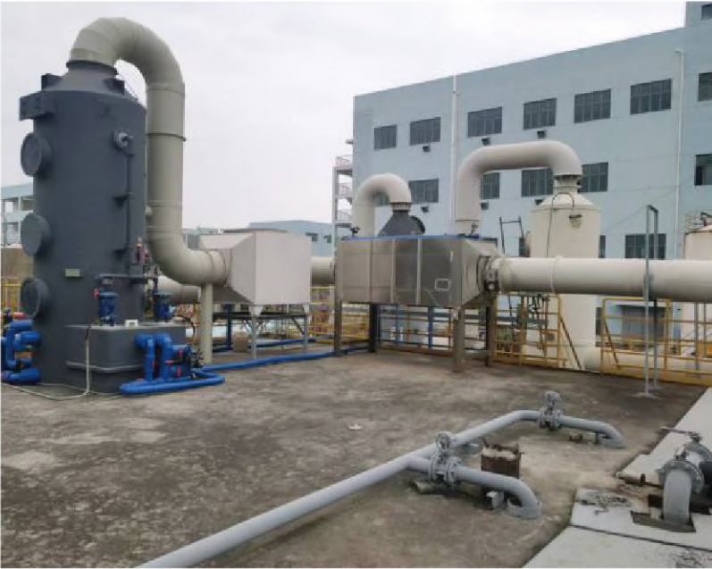
博瑞泰兴废气处理设施
