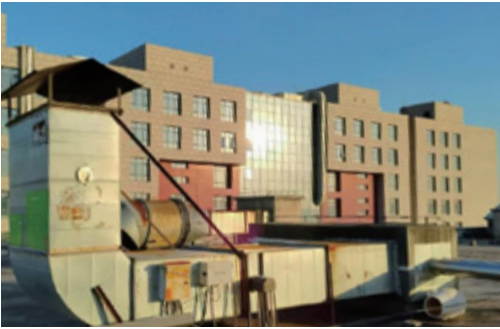
同仁堂大兴分厂屋顶废气监测
