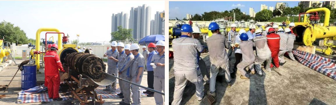
天然气高压管线的内检测工作
