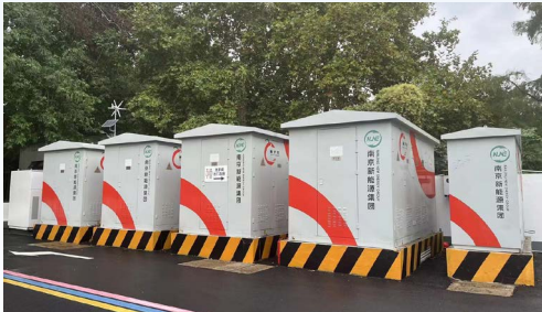
雨花东路场站储能柜 + 箱变
