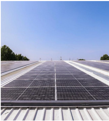
厂区屋顶光伏系统
