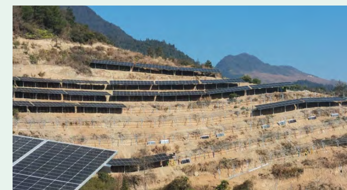
丽水分行碳减排贷款支持光伏项目建设
