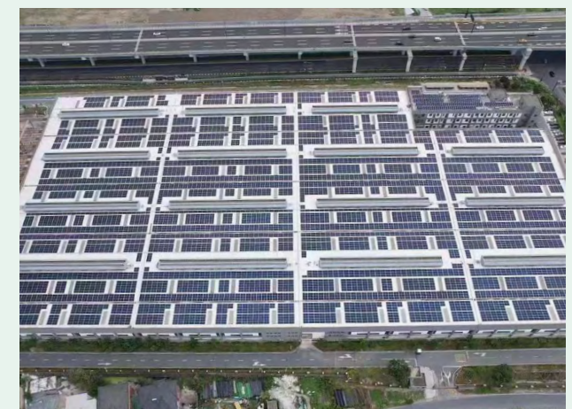
杭州绿色地铁“光伏 + 节能”项目
