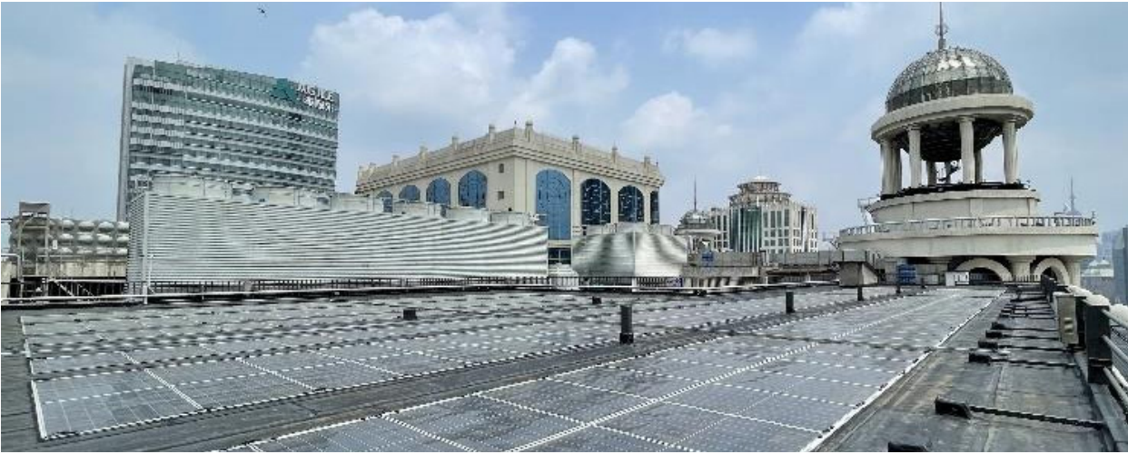
公司屋顶光伏发电系统
