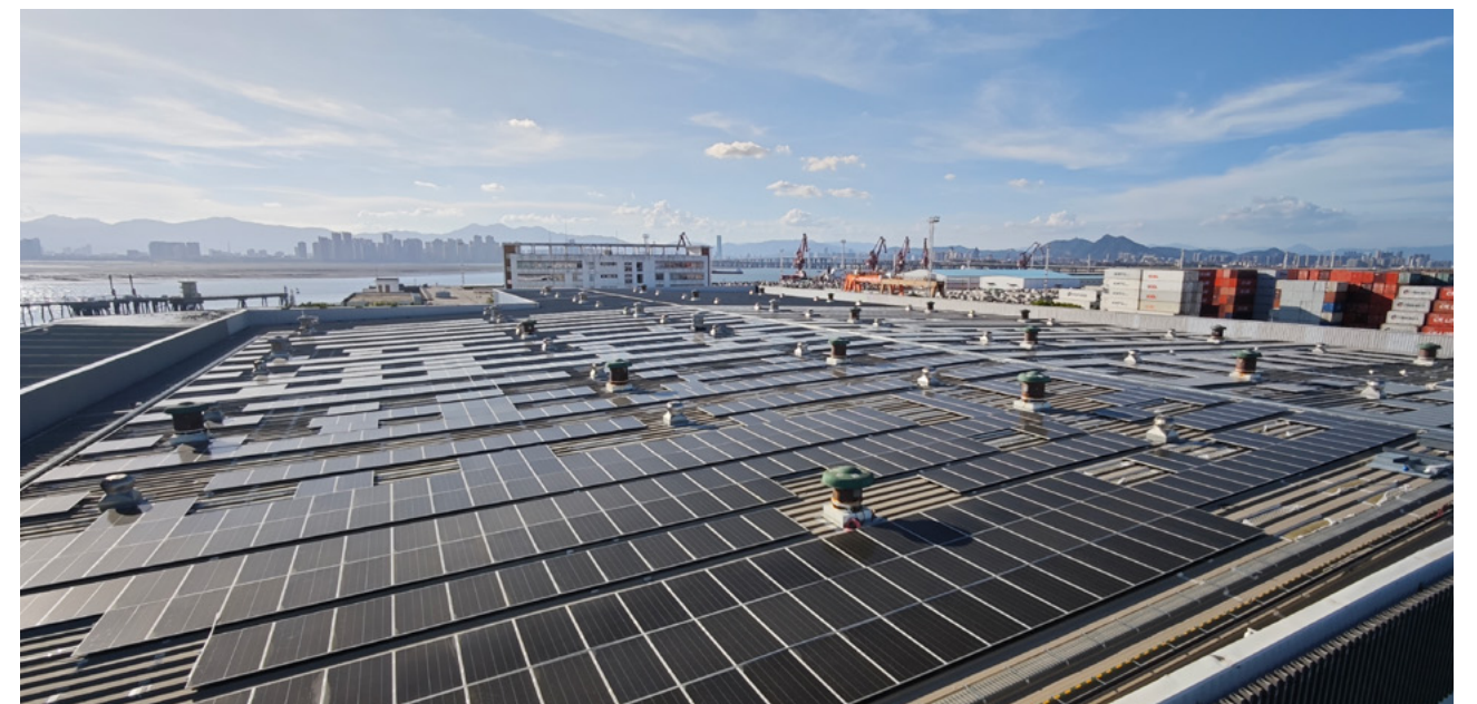
● 厦门现代码头建发物流中心光伏电站
