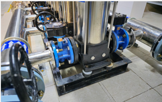
● 水泵房隔音板设置
