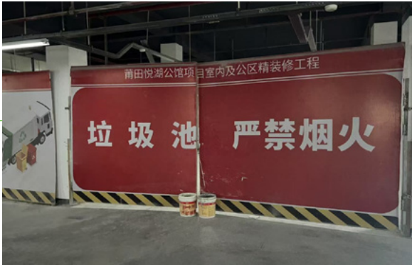
施工废弃物收集池
