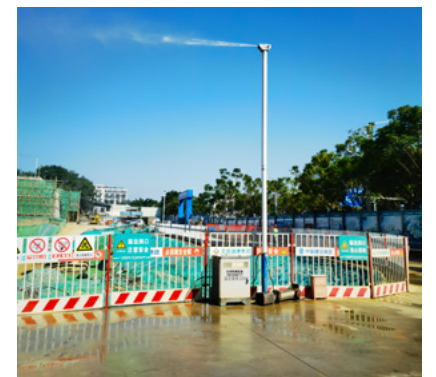
● 高杆喷淋系统
