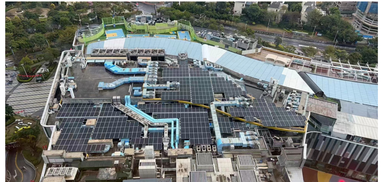
● 厦门建发湾悦城光伏电站
