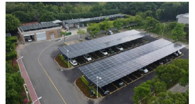
● 厦门国家会计学院光伏电站及充电桩一体化项目
