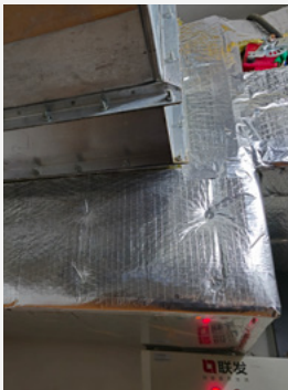
● 风机房静压箱防火包裹兼隔音设置
