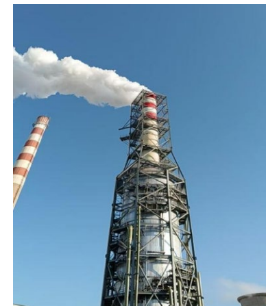
热电公司脱硫塔
