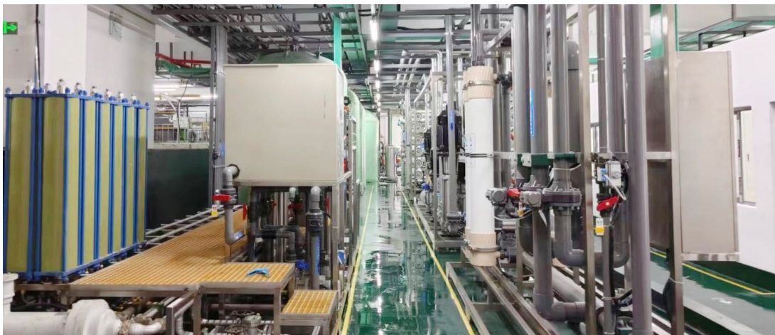
零排放污水站
