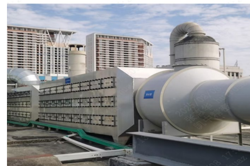
废气治理升级项目
