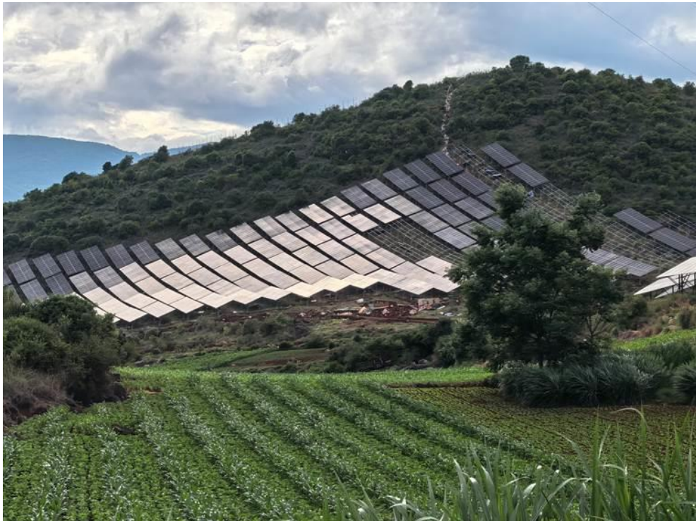
云南保山 600MW 光伏发电工程
