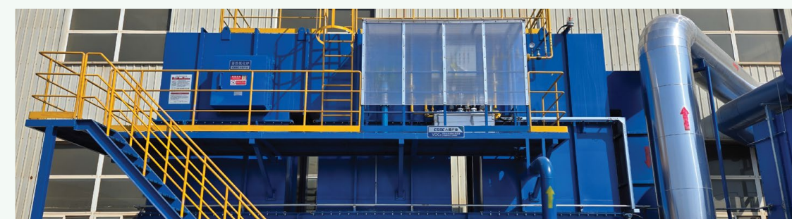
RTO有机废气处理设施
