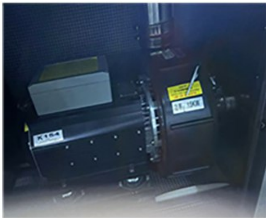
改造后安装变频器
