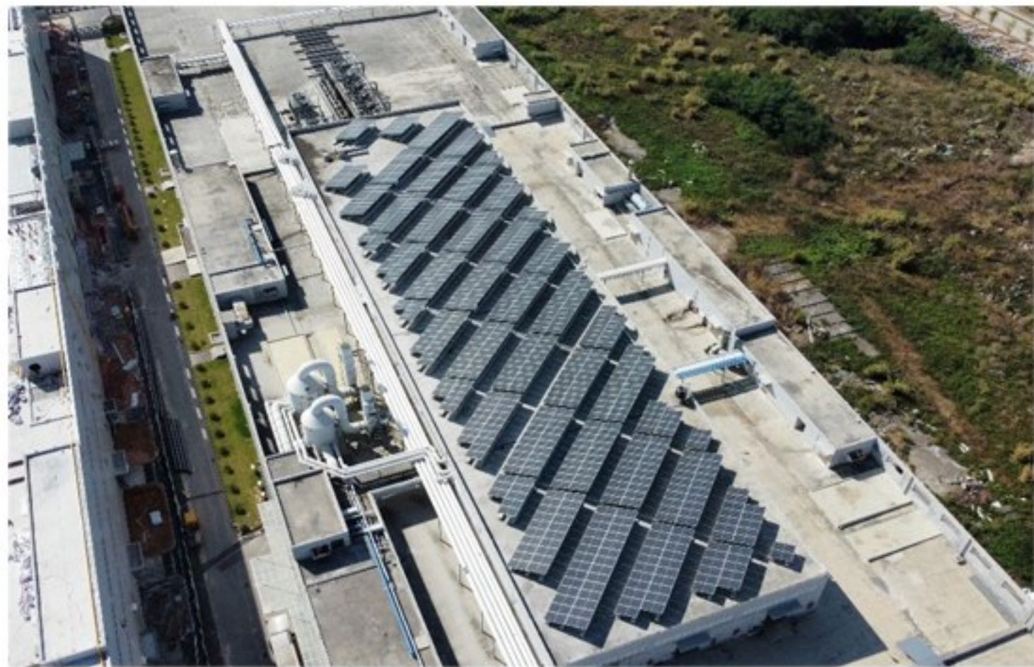
光伏节能设施
