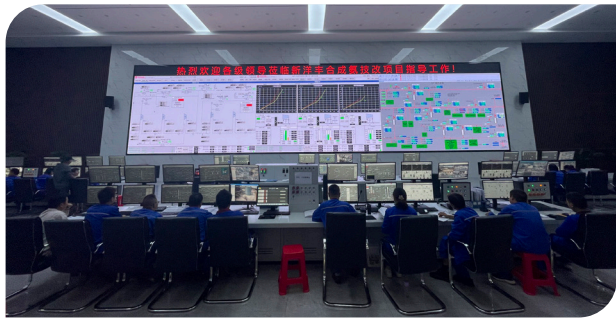
新合成氨厂数字化转型项目中控室
