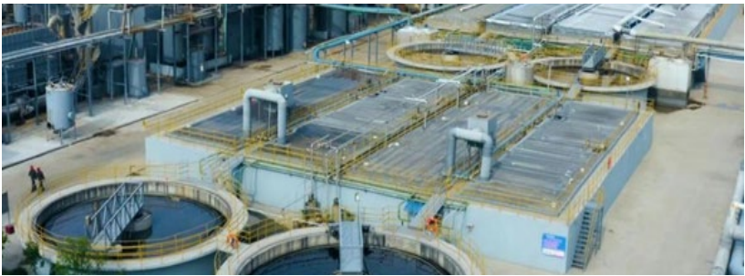
公司废水处理站
