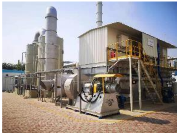
图注：威远生化 RTO 装置
