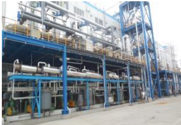
图注：威远生化“水喷淋+活性炭/树脂吸附/脱附”设施
