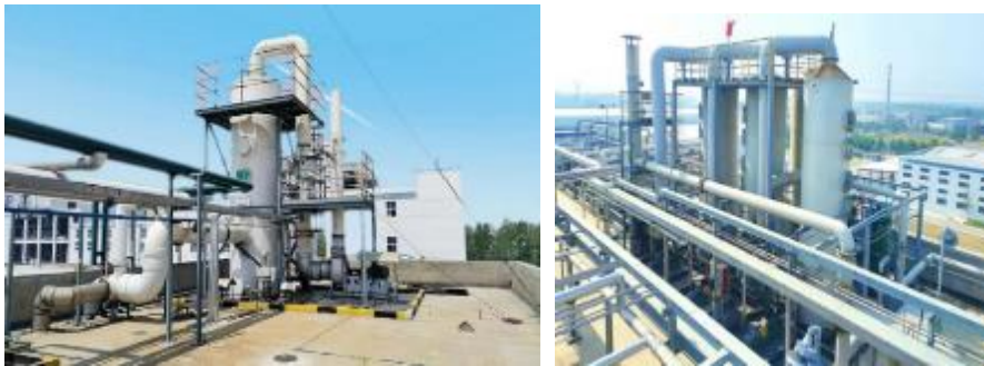
图注：利民化学尾气喷淋装置
