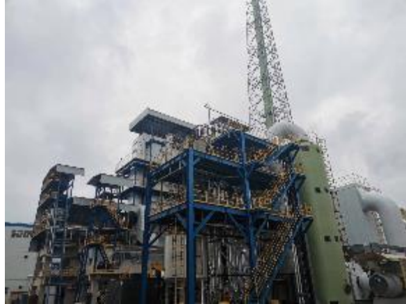
图注：威远生化焚烧炉装置
