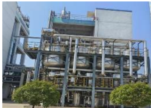
图注：利民化学氯乙烷树脂吸附装置
