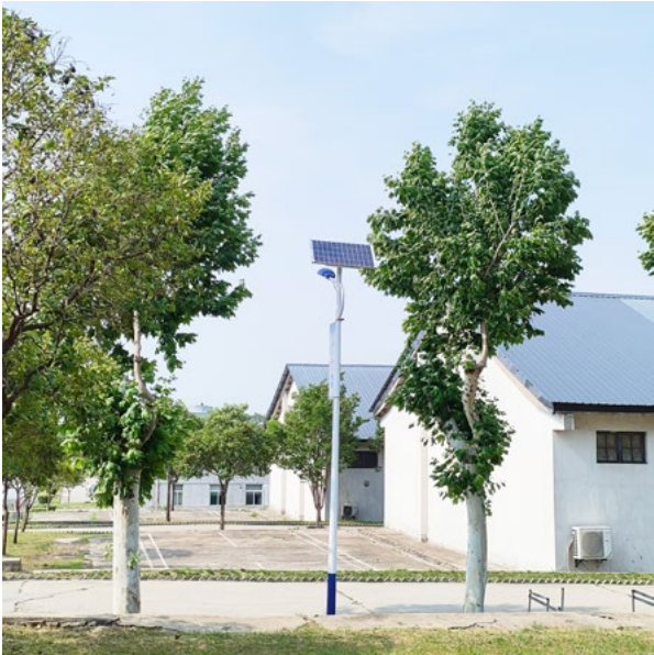
太阳能路灯项目
