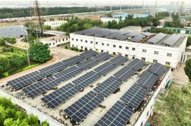
5.93兆瓦分布式光伏电站
