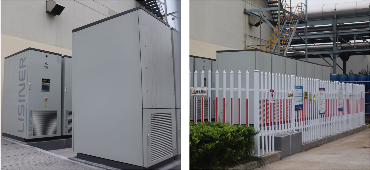
大江东储能项目
