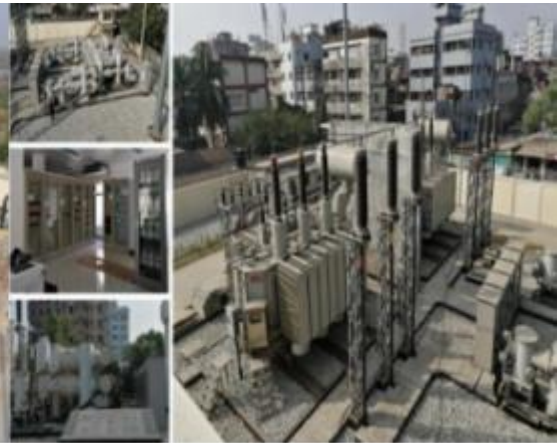
图 8：孟加拉 132kv 变电站
